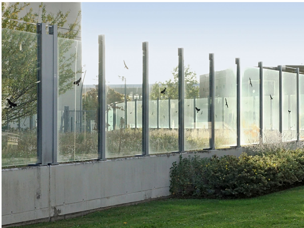
Les silhouettes autocollantes de rapaces indiquent en général que des problèmes de collision ont été constatés. Elles ne contribuent toutefois pas à atténuer les risques et ne devraient pas être utilisées, car des oiseaux continueront à voler contre les vitres à côté des silhouettes. Un marquage éprouvé, couvrant l'ensemble de la surface, doit être utilisé.
